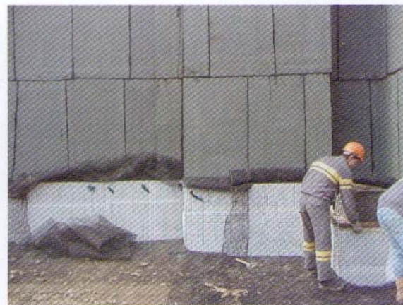
Photo 3 Mise en œuvre de la géogrille sur les panneaux polystyrène Application of the geogrid over the polystyrene panels
