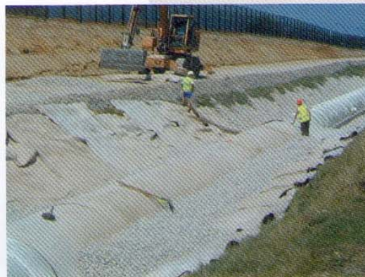
Photo 5 Mise en place de la grave drainante au-dessus de la membrane Laying the draining gravel-sand mixture above the membrane
